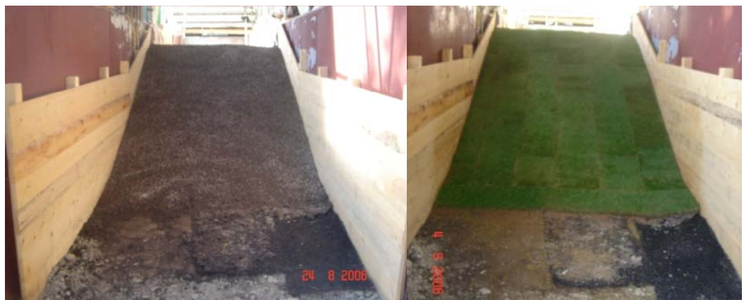
Abbildung 4.6-2 Andecken des Deiches mit Oberboden inklusive Wirrgelege (links) und eingebrachte Fertiggrasensoden (rechts)
